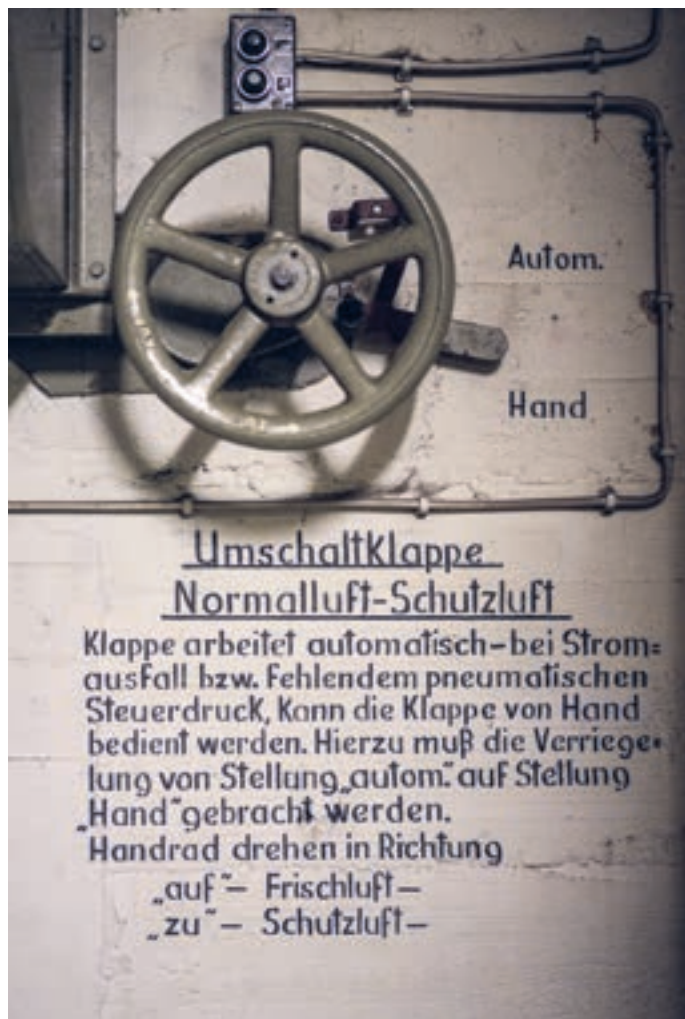
Die Waschbecken im Sanitärraum sind außer Betrieb. Die grünen Aggregate, Teil der Belüftungsanlage, funktionieren noch (Bild oben). Mit dem Handrad lässt sich die Luftschutzklappe des Bunkers bedienen.
